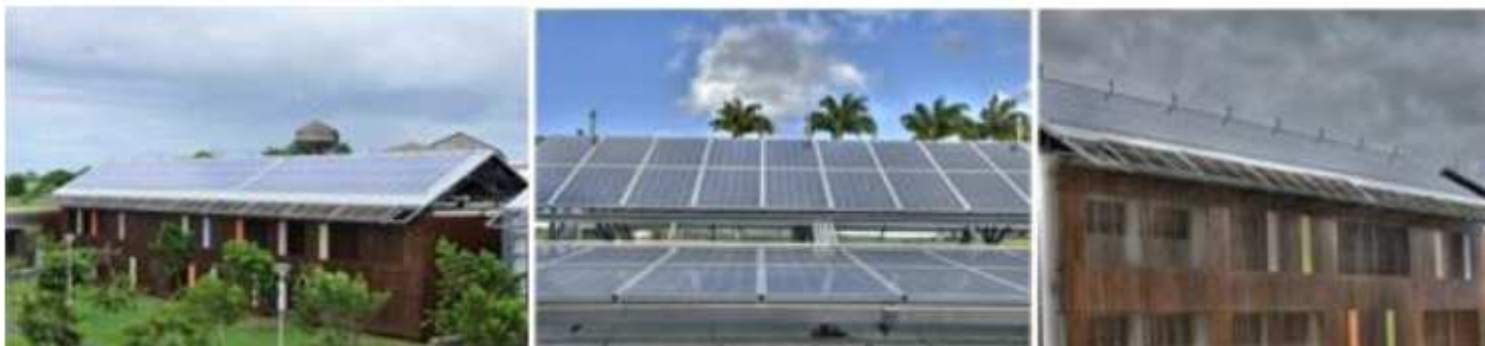
Figure 524 Exemple d'installations photovoltaïque - Source Guadeloupe Energie
